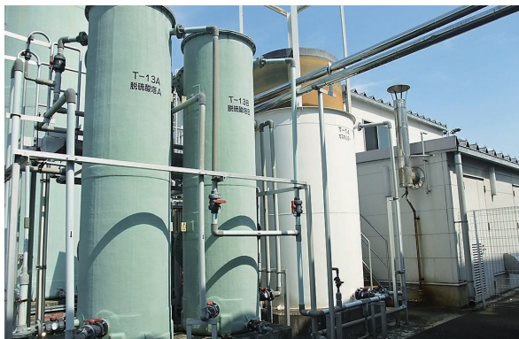
廃水処理時に発生するメタンガスで発電するバイオマス発電
