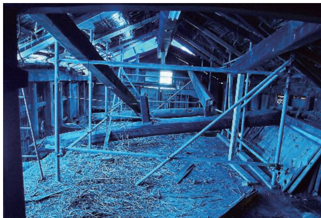
震災のダメージを負った十八間蔵の内部
